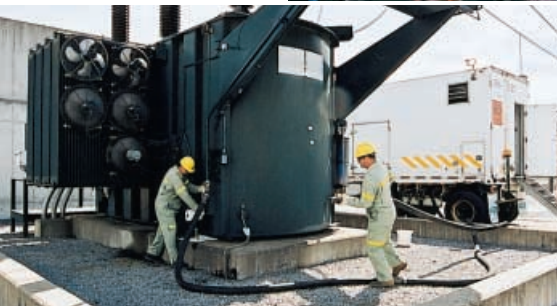
Traitement des huiles minérales isolantes
